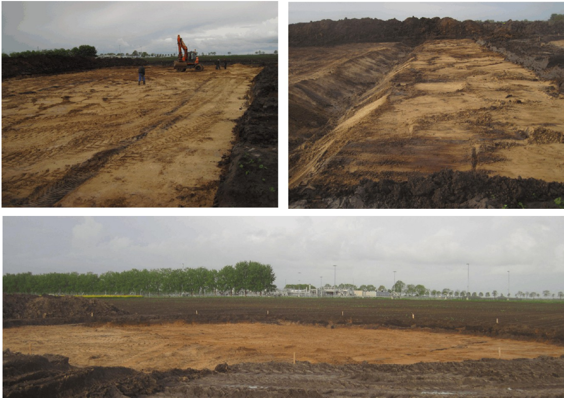
Figuur 25. Midwolda, Kerkelaan: foto's van de vlakken. Boven Locatie 4 Stal: de linkerfoto is genomen richting het westen en de rechter richting het zuiden. Op de rechterfoto is een uitgegraven recente sloot te herkennen. Onder is Locatie 5 Silo afgebeeld. Deze foto is genomen richting het westen.
